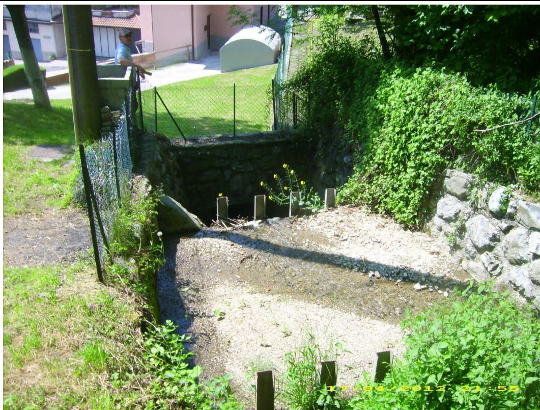
Foto Punto di intubamento della Valel Cornello
