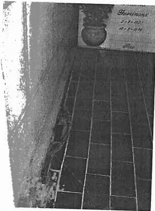
Foto n.19 Particolare delle lesioni presenti nel pavimento di una delle cappelle presenti sul lato est del cimitero
