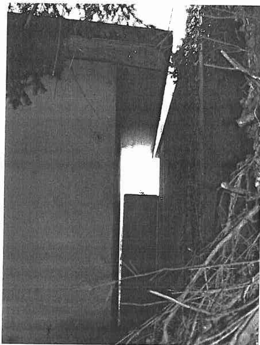
Foto n.16 Particolare del distacco tra due cappelle private presenti sul lato est del cimitero (vista dall'esterno del cimitero), in origine le solette di copertura delle due cappelle erano state costruite in aderenza
