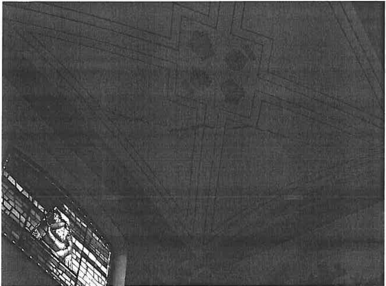
Foto n. 1 particolare di una fessura presente nella volta
