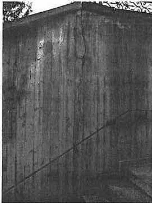
Foto n.10 Fessura presente nel muro in c.a. realizzato a lato della scala di accesso all'ampliamento del 1990 (lato ovest della scala)
